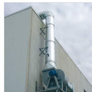
Impianti di aspirazione
